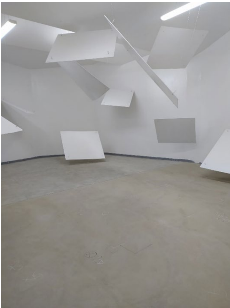
Obr. č. 1 Prázdná dozvuková komora
